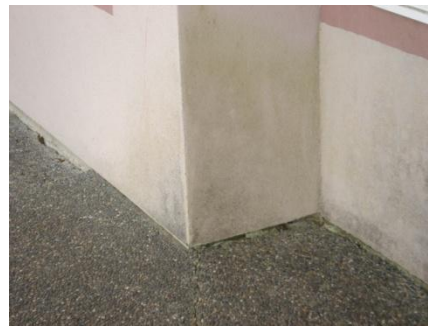
图 2 坡面倒置造成的外墙潮湿 1
