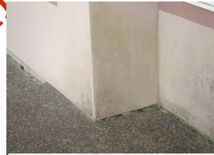
圖 2 坡面倒置造成的外牆潮濕 1
